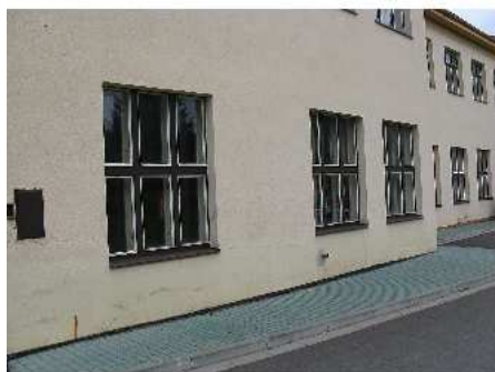
Starý stav před opravou
